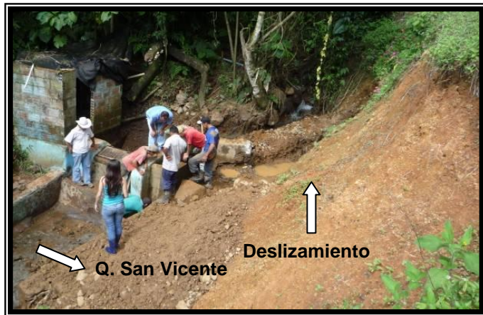
Foto D. Daños en la Bocatoma San Vicente
